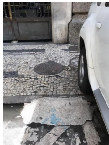
Figura 34 Rampa improvisada Fonte: Própria
