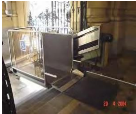
79 - Rampa elevatória Fonte: Fonte: https://www.guiadasartes.com.br/sao-paulo/sao-paulo/casa-da-imagem
